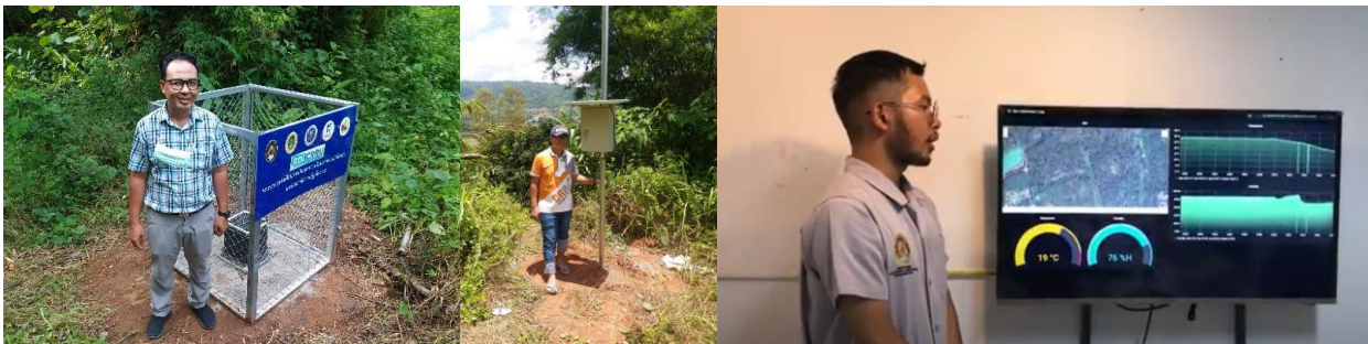
รูปที่ 7 แสดงอุปกรณ์เซ็นเซอร์ตรวจจับความร้อนจากการเกิดไฟฟ้าที่ติดตั้งใช้ในการทดสอบในงานวิจัย
