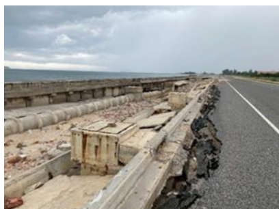
ภาพที่ 5 แนวกันคลื่นที่ได้รับความเสียหายจากการกัดเซาะชายฝั่ง บริเวณหมู่ 2 ตำบลชิงโค อำเภอสิงหนคร จังหวัดสงขลา
