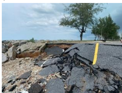
ภาพที่ 4 ถนนที่ได้รับความเสียหายจากการกัดเซาะชายฝั่ง บริเวณหมู่ 2 ตำบลชิงโค อำเภอสิงหนคร จังหวัดสงขลา
